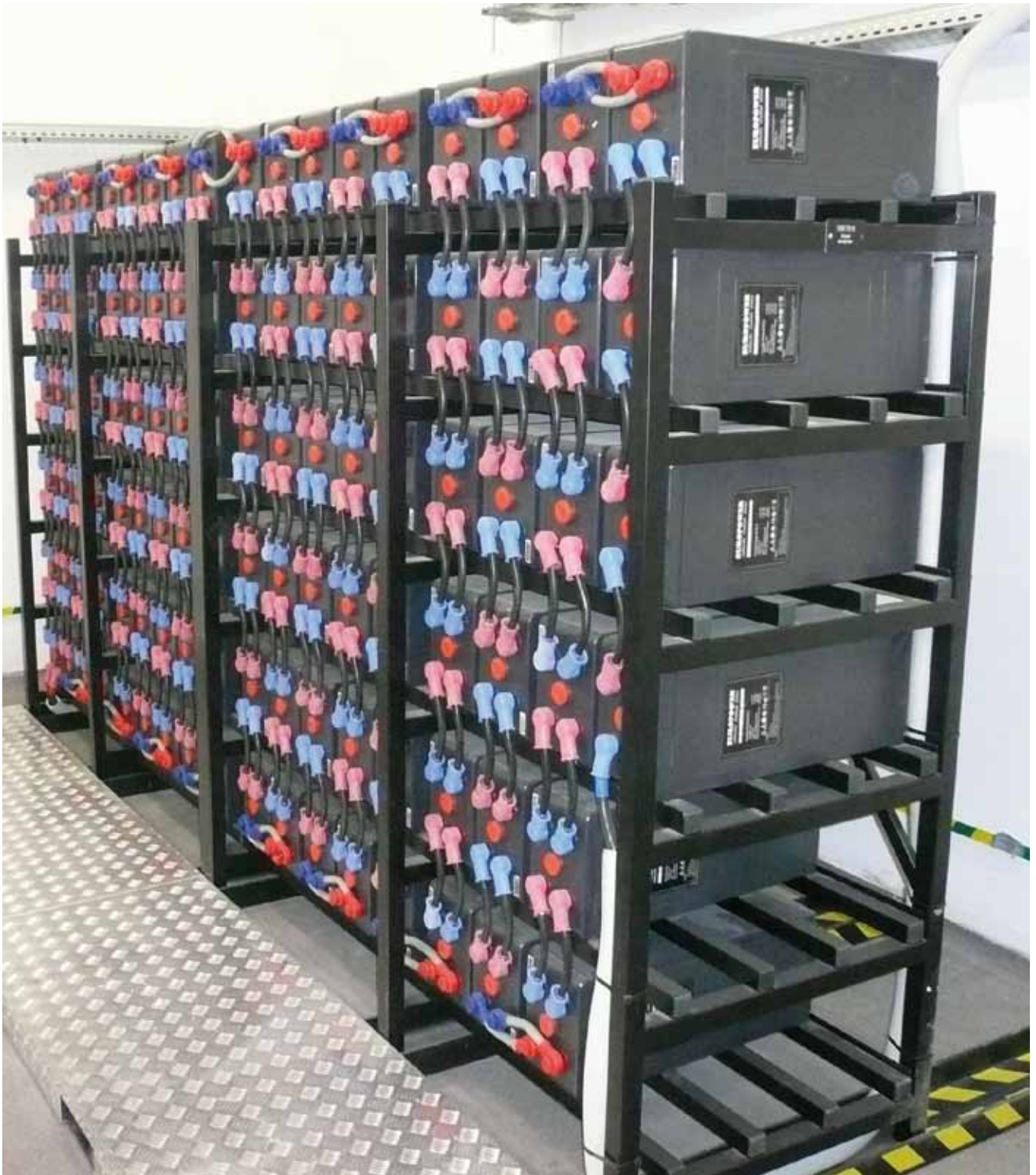
Jedna z 2 baterii 220 V, 800 Ah pracujących w Elektrociepłowni w Częstochowie, złożona ze 106 szt ogniw EXL-800N
