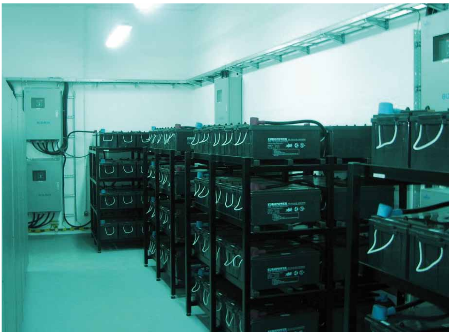
160 szt. akumulatorów EPL 210-12 pracujących z 4 zasilaczami UPS 200 kVA w serwerowni w Warszawie
