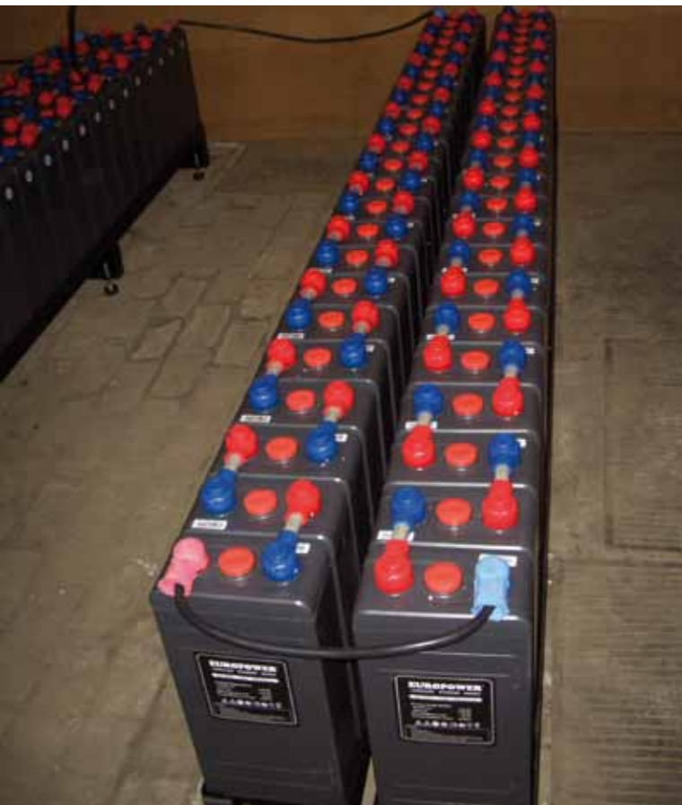
Bateria 220 V, 200 Ah pracująca w Instytucie Energetyki w Warszawie...
