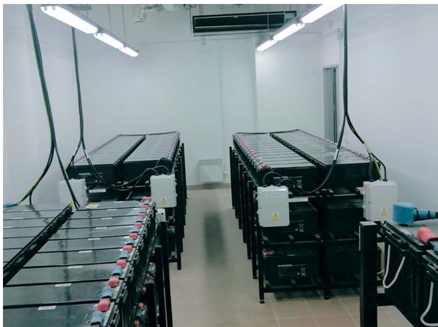
Rys. 2. Instalacja 297 sztuk akumulatorów EPS 200-12 pracujących z trzema zasilaczami UPS 120 kVA w Centrum Medycyny Inwazyjnej w Gdańsku
