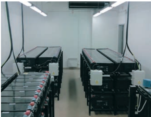
Instalacja 297 szt. akumulatorów EPS 200-12, pracujących z 3 zasilaczami UPS 120 kVA w Centrum Medycyny Inwazyjnej w Gdańsku
