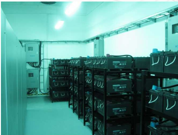
Serwerownia w Warszawie, 1360 szt. EPL 210-12
