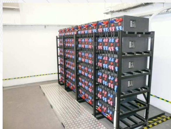
Elektrociepłownia w Częstochowie, 212 szt. EXL-800
